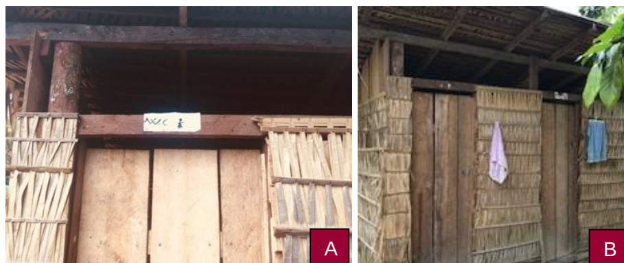
Figura 34 - Banheiro comunidade Cipiá.
